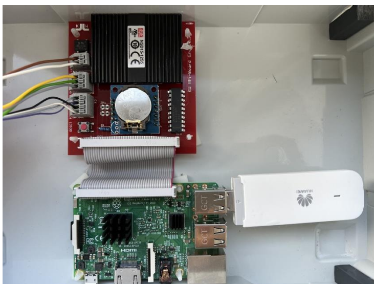
Abbildung 4: Wartungsbox V3 mit LTE-Stick Innenansicht
