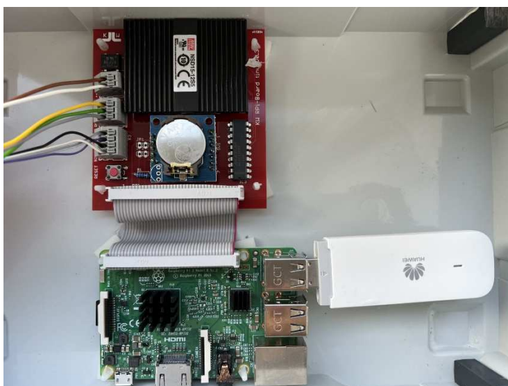
Abbildung 4: Wartungsbox V3 mit LTE-Stick Innenansicht
